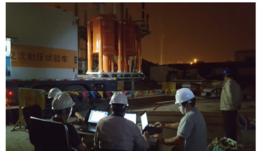
无锡红震4k52、荆震2k63线 220kV竣工实验局放检测 Wuxi 220kV project
